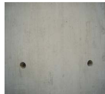
图 2 超长结构混凝土表面部分情况
